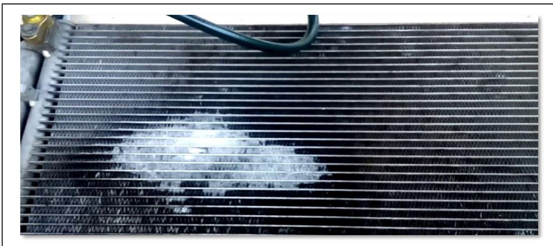
ภาพที่ ๔.๒๔ แสดงสภาพผิดปกติมีการรั่วซึมของระบบ
